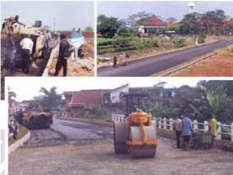
Foto-foto pengerasan jalan dari Jalan Raya Bojongsoang ke STT Telkom medio 90-an (Sumber: Telkom Foundation)
